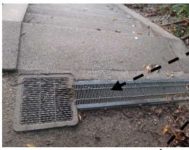
昨年の大雨であふれた排水口。落ち葉が詰まってました
