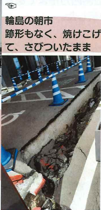
輪島市役所人口 建物回りは損壊がひどい。市 役所内では、罹災証明の手續 きなど他自治体職員らが応援 に入っていました。
